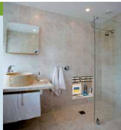
Bad mit bodengleicher Dusche und Vakuumpumpe
